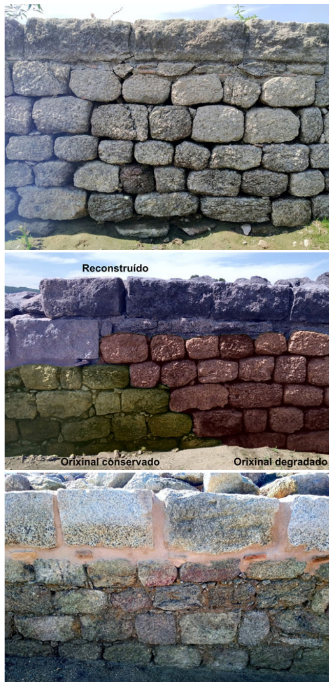
Fig. 21. Paramento interior da muralla SO ao sur da porta decumana (sectores 3 e 4). Arriba, degradación moi severa do paramento orixinal no sector 3 [foto F. Pérez Losada, xullo 2020]. En medio, comparativa do estado de conservación da muralla orixinal no sector 3, escavada desde moi antigo (37 anos), e no sector 4, recen exhumada (2 anos) [foto F. Pérez Losada, xullo 2020]. Abaixo, paramento da muralla orixinal no sector 4, polo de agora bastante ben conservado –xuntas perfectamente recheadas con ripios e argamasas– [foto M. Lago Cerviño, novembro 2019].
