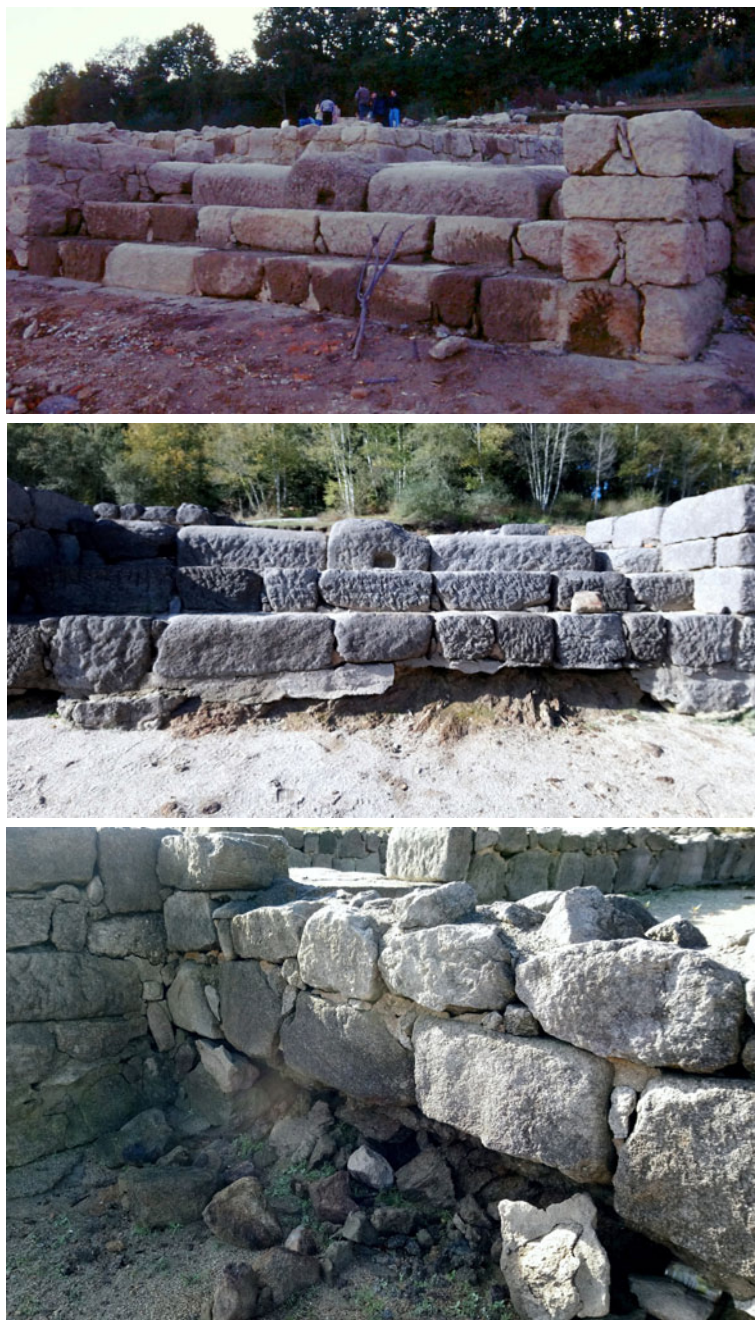
Fig. 22. Fachada principal (NL) do edificio da mansio , amosando un grao de afección moi severo, incluso crítico, pola erosión do encoro. Arriba, estado de conservación das escadas de entrada ao edificio en outubro de 1996, recen concluídas as obras de consolidación e restauración [foto F. Pérez Losada]. En medio, estado de conservación da mesma entrada en novembro de 2019, cos alicerces totalmente erosionados polas augas [foto M. Lago Cerviño]. Abaixo, paramento do muro a carón da entrada, totalmente erosionado e disgregado polo encoro, tanto a parte orixinal como a reconstruída, en risco de colapso inminente [foto M. Lago Cerviño, novembro 2019]
