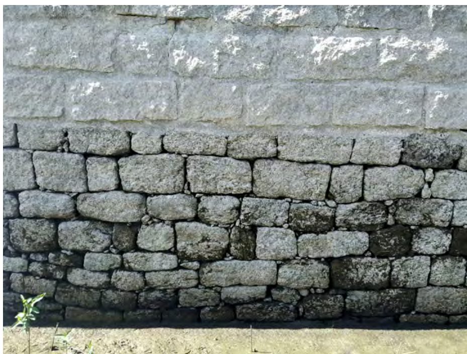
Fig. 20. Paramento interior da muralla SO ao norte da porta decumana (sector 1), coa parte orixinal conservada intensamente afectada pola acción erosiva do encoro [foto 1 M. Lago Cerviño, novembro 2019; foto 2 F. Pérez Losada, xullo 2020].
